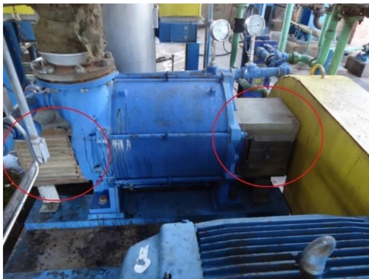
Figura 6 - Proteção dos mancais
