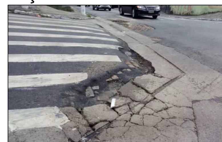
Figura 2. Situação de rua danificada em Porto Feliz
